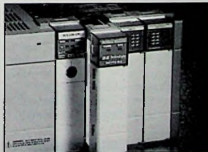
23. profibus Scanner met SLC 5/04.
